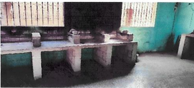
Foto 3: remosamiento de estufa tipo rural, colocacion de chimenea, colocacion de plancha para cocinar, cambio de lamparas y colocacion de tomacorrientes
